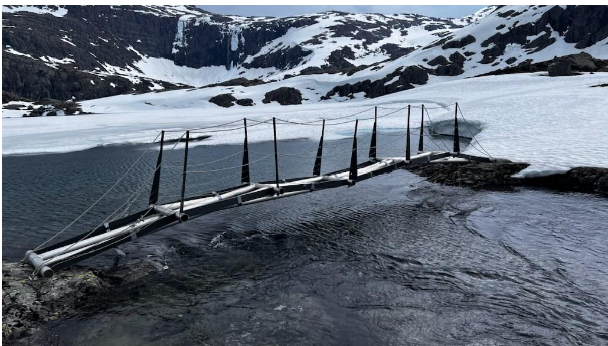
Bilete 6. Brua ved Skarvevatnet våren 2024. Konstruksjonen har fått seg ein «knekk» i løpet av vinteren og må reparerast. To store røyr i den berande konstruksjonen er bøygde og må byttast ut.
