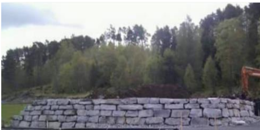
Figur 30: Eksempel på hvordan en natursteinsmur kan bli seende ut. Foto: Statens vegvesen
