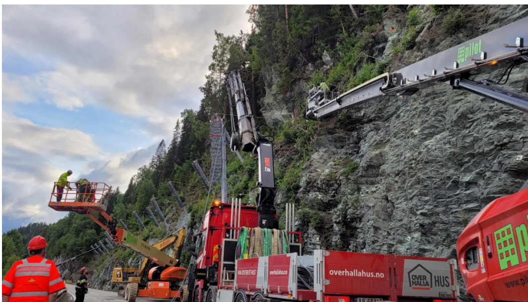
Figur 19: Eksempel på montering av fanggerde fra veg, fra Vegvesenets prosjekt E6 Langnesberga. Foto: Statens vegvesen
