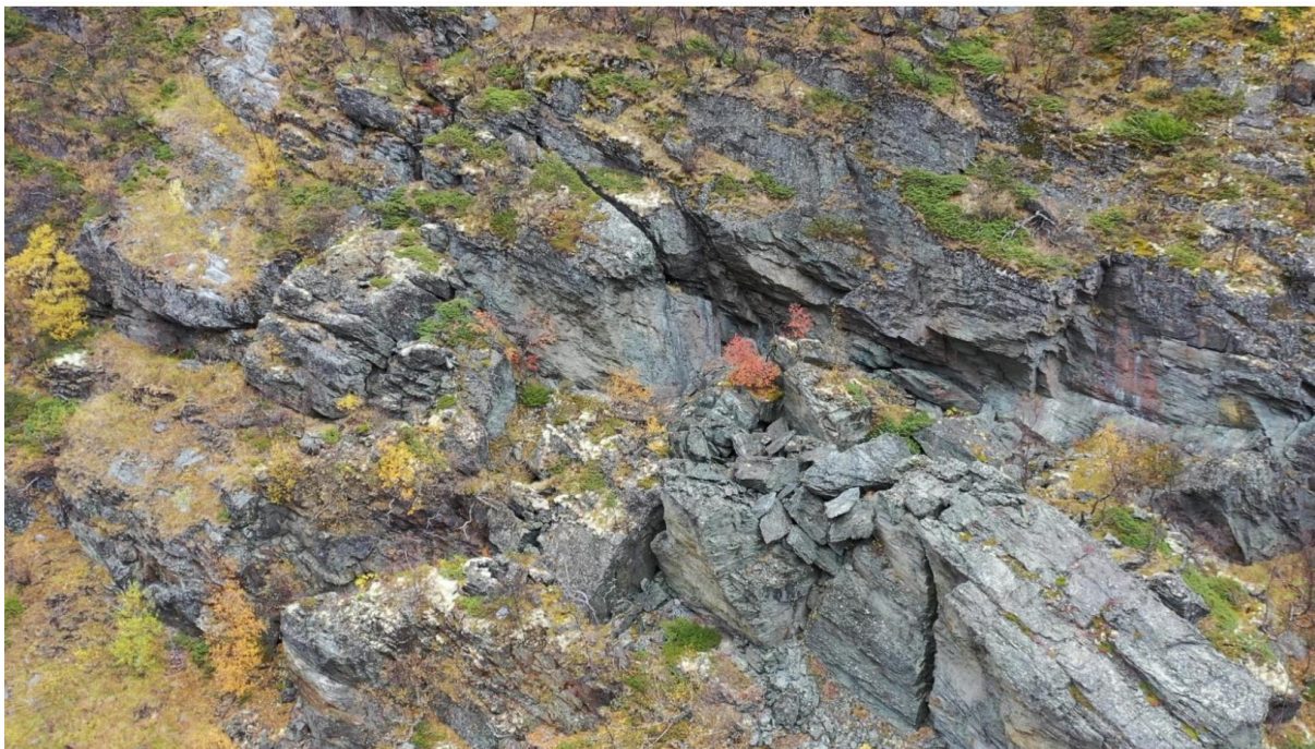
Figur 5: Eksempel på løse steiner. Bilde fra oversiden av Vårstigen ca midt i tiltaksområdet. Foto: Statens vegvesen
