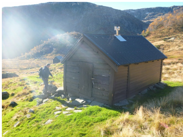
Selet slik det stod i 2013 hadde svarte blekkplater på taket
