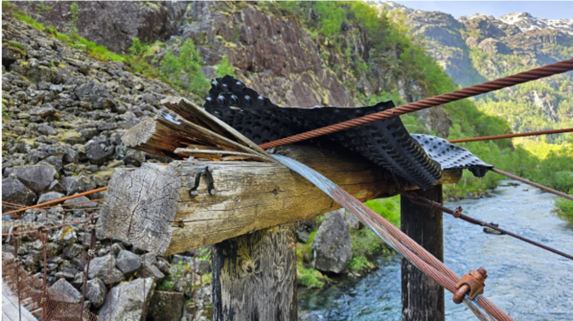
Råte tverrstokk, må bytast før brua kolapser
