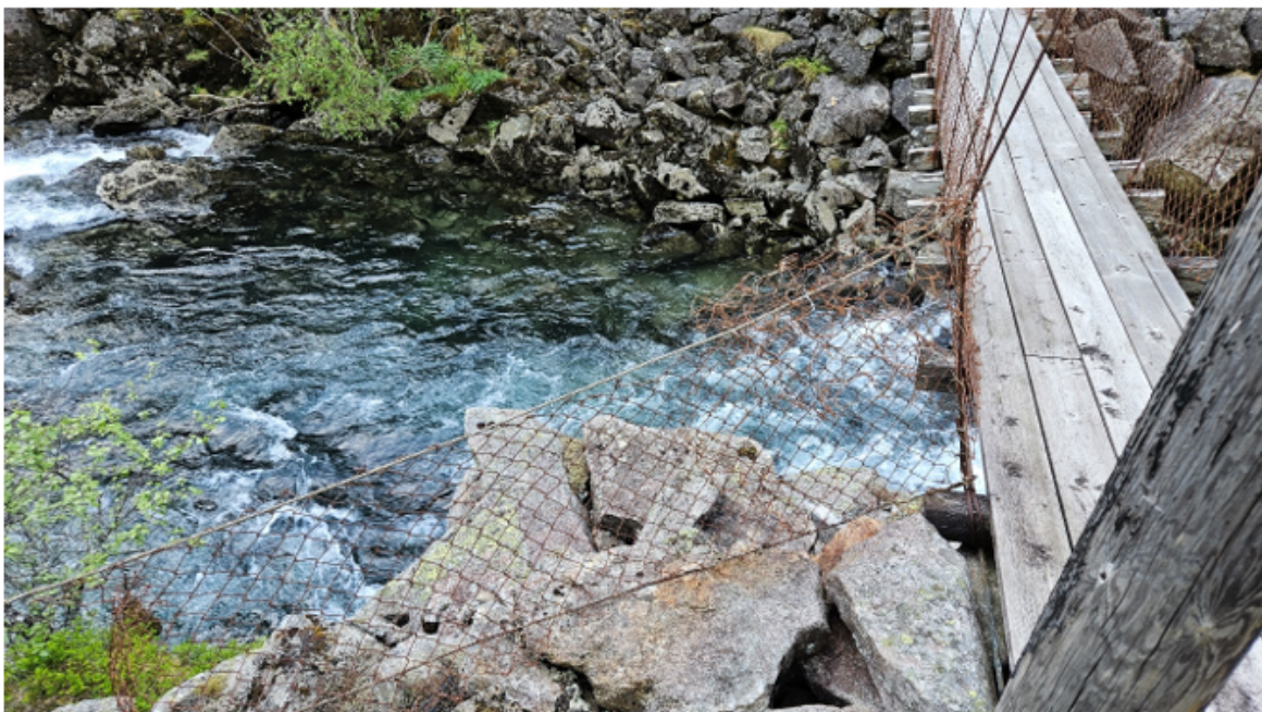
Dårleg rekkverk, farleg for folk og dyr
