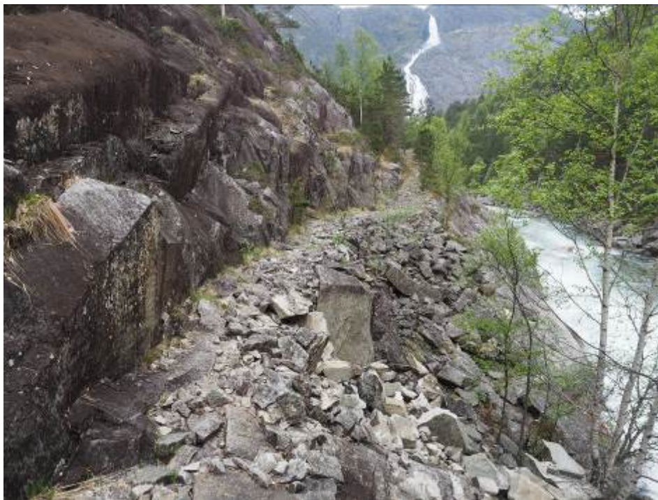
Figur 3. Stien er stadvis steinete og grov og går tett på Mosneselva. Den berer preg av tidlegare utbetring opp gjennom tidene. Stien er stadig utsett for flaum, der elva grev seg lenger inn i kantane og drar med seg massane som danna berelaget på stien.
