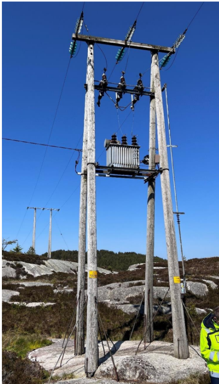
Eksempel på transformator i mast
