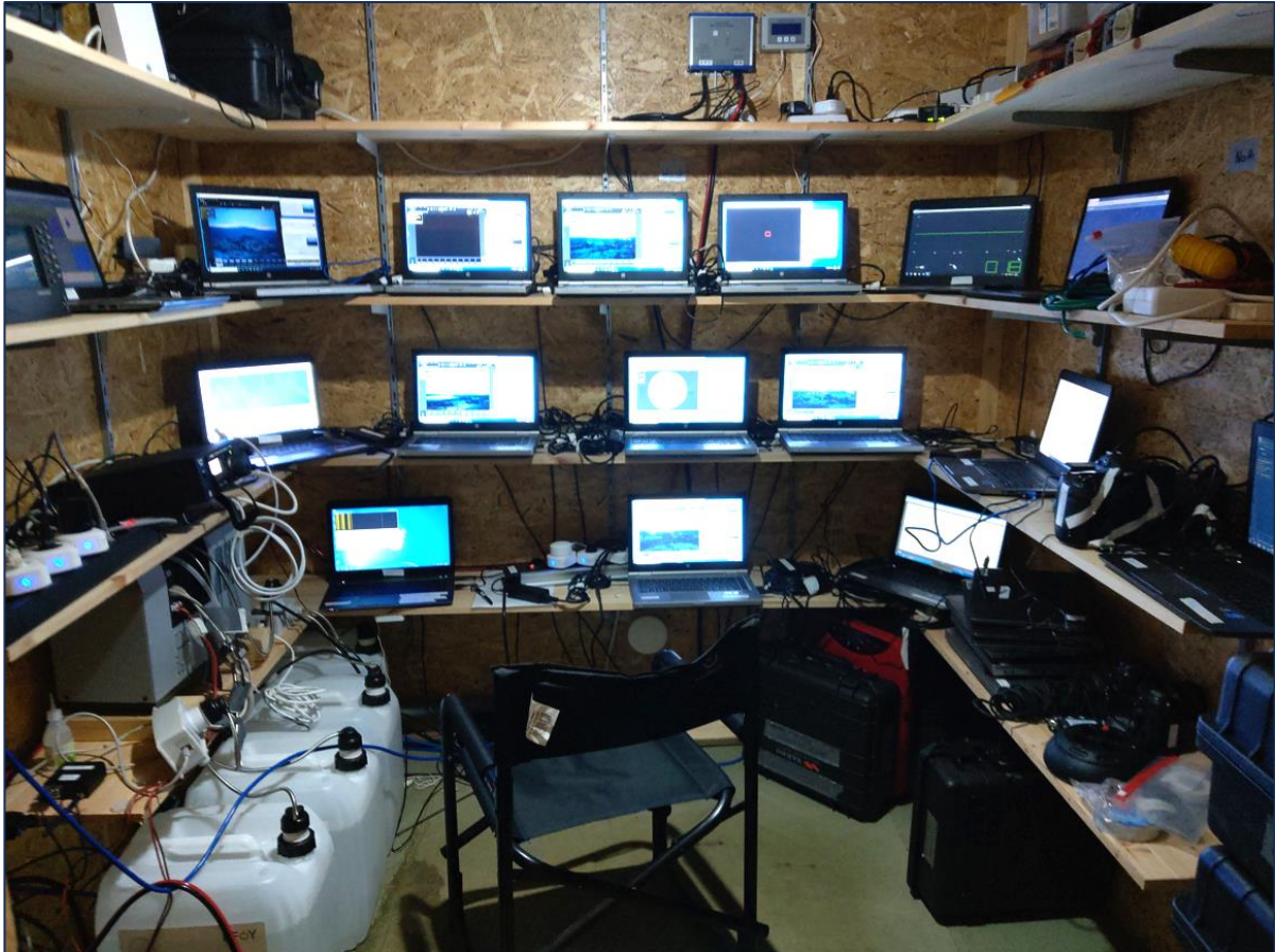
Datarom i Hessdalen observatorium for kontinuerlig måling og logging av data. Strømforsyning via solceller, vindmølle og metanol brenselcelle (ned til venstre)
