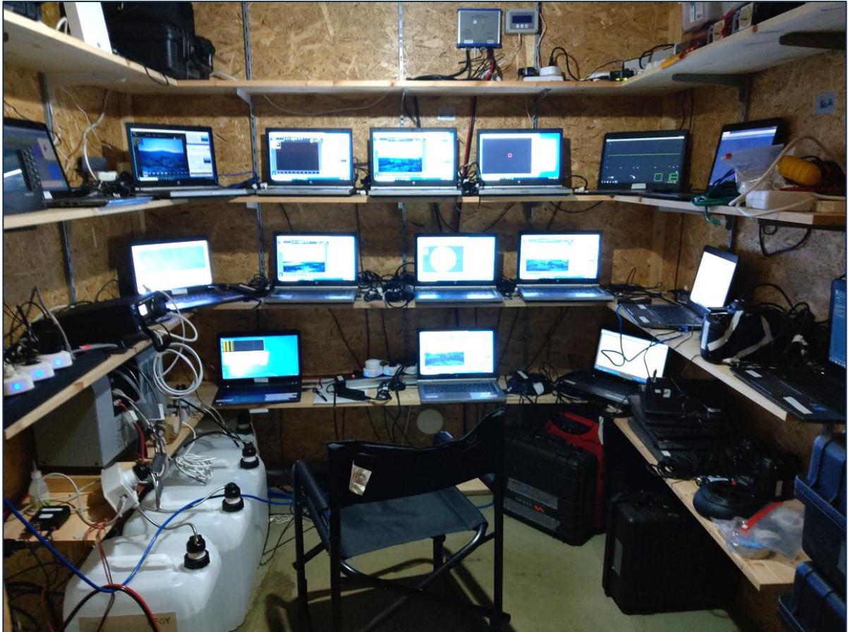
Datarom i Hessdalen observatorium for kontinuerlig måling og logging av data. Strømforsyning via solceller, vindmølle og metanol brenselcelle (ned til venstre)
