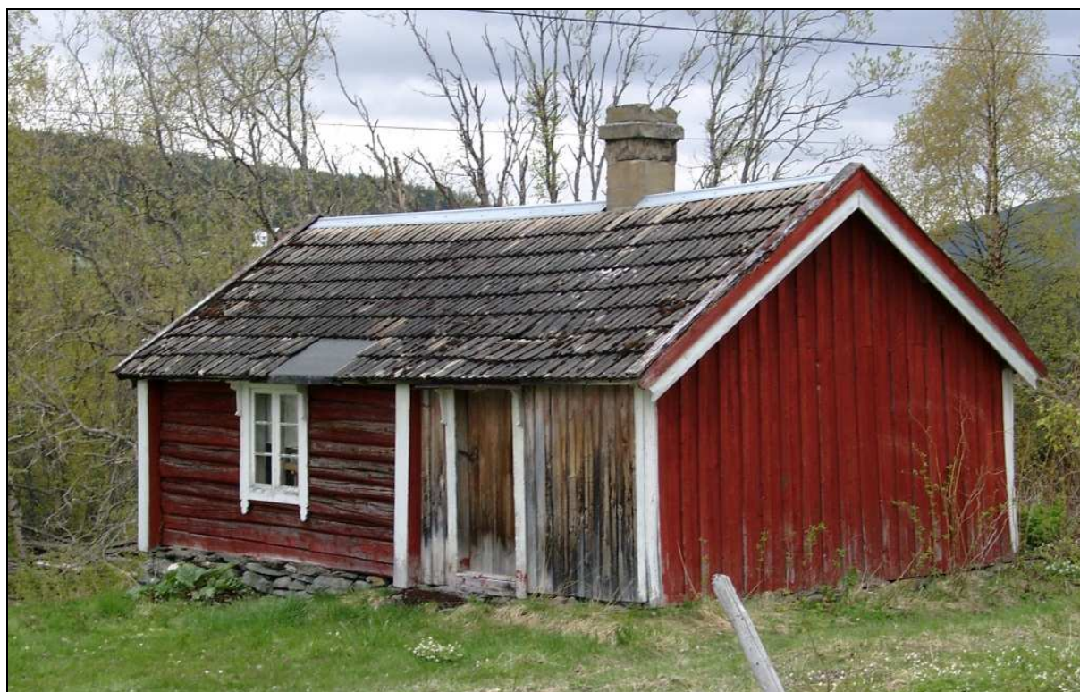
Figur 7. Mastuer, smier og stabbur er i større grad enn mange av de andre uthusa tatt vare på. Dette kan ha sammenheng med at de er små og relativt enkle å vedlikeholde, samtidig som det er lett å finne alternative bruksområder for dem, som f.eks. lager.
