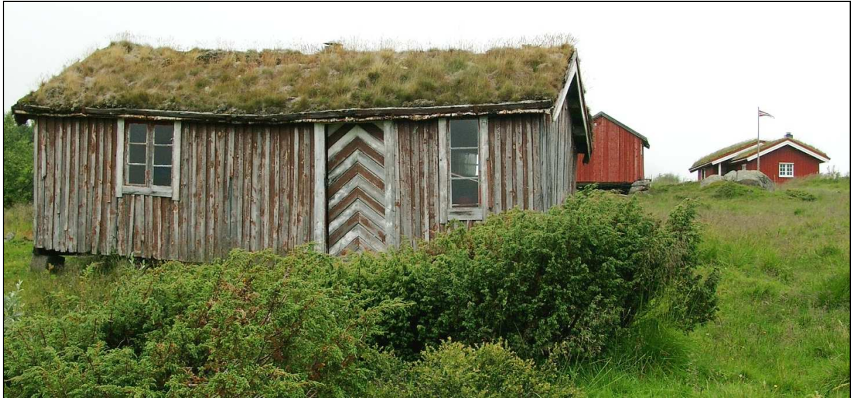
Figur 25. Den gamle seterstua på Almåsvollen er i begynnelsen av forfall. Den er likevel fullt mulig å sette i stand, og vil da være et verdifullt element i dette kulturlandskapet.
