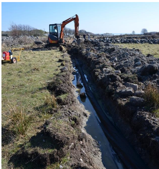
Figur 29: Åpning av gamle grøfter som er grodd til i 2014. Foto: Torstein Kiil
