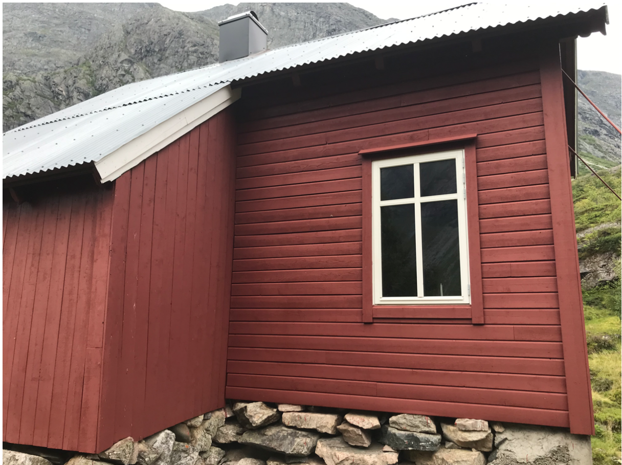
Figur 2 Sørvest sida på turisthytta. Solcellepanelet er søkt plassert på veggen med vindauga, oppunder rafta.
