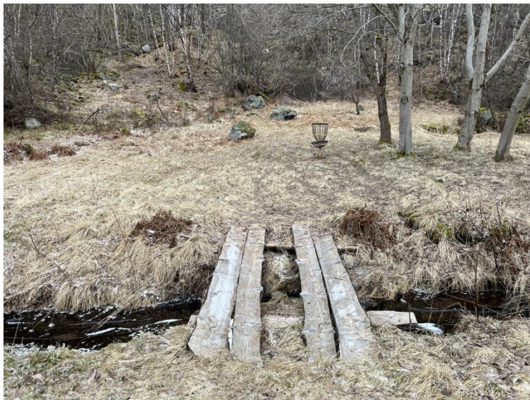
Bilete syner eksisterande bru, som ikkje er tilfredstillande stand i forhold til rullestol og barnevogn. Ny bru vert laga på same stad, men vert tettare og med rekkverk på eine sida.
