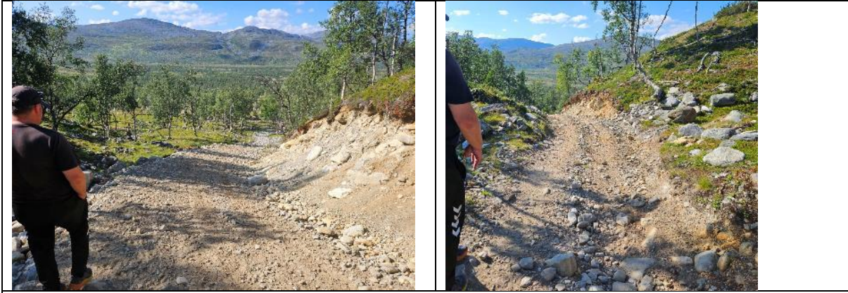
Tiltak: Sortering og arrondering av eksisterende, stedlige masser og legging av tverrfall på vei.
