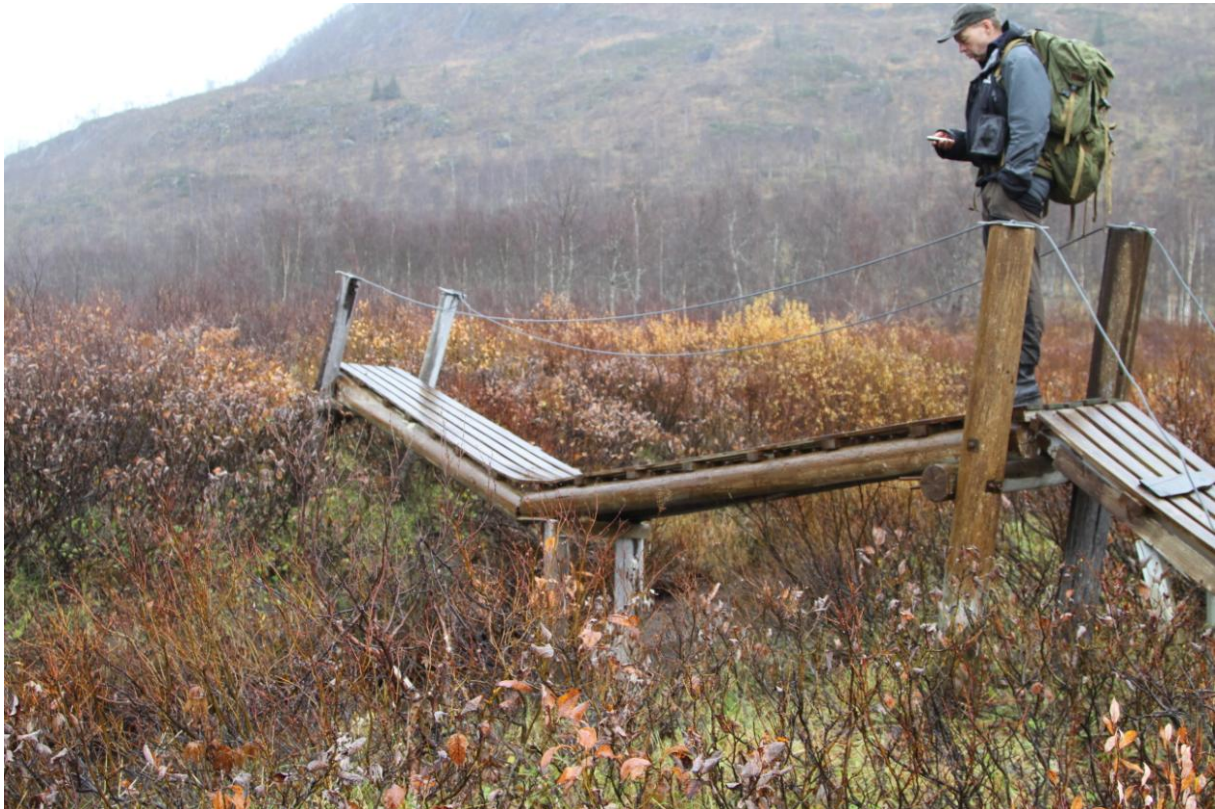
Ødelagt bru Stormdalen. Foto: Kristian Sivertsen
