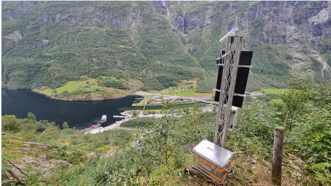
Figur 3 Mast 1 ved Nautgrovi. Foto Vestland Fylkeskommune
