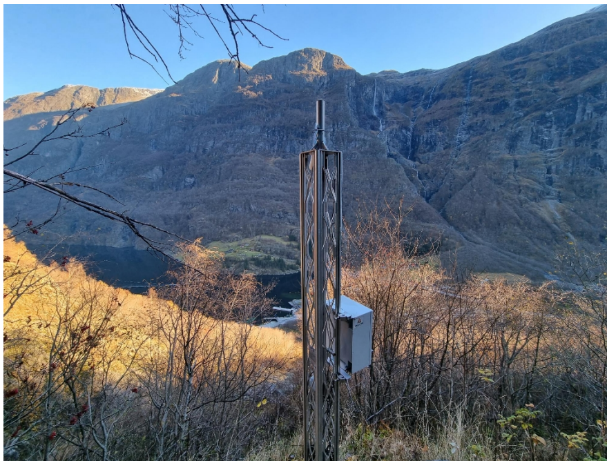
Figur 4 Mast 2 ved Nautgrovi. Foto Vestland fylkeskommune
