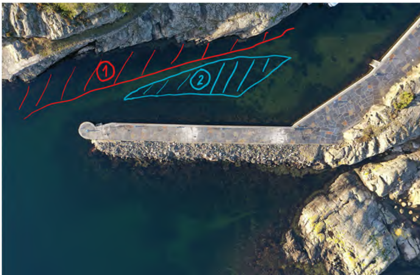
Figur 1 - Spredning av sprengstein som følge av erosjon fra eksisterende molo
