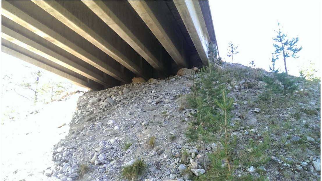
Brufundament er dekt av lausmasser.
