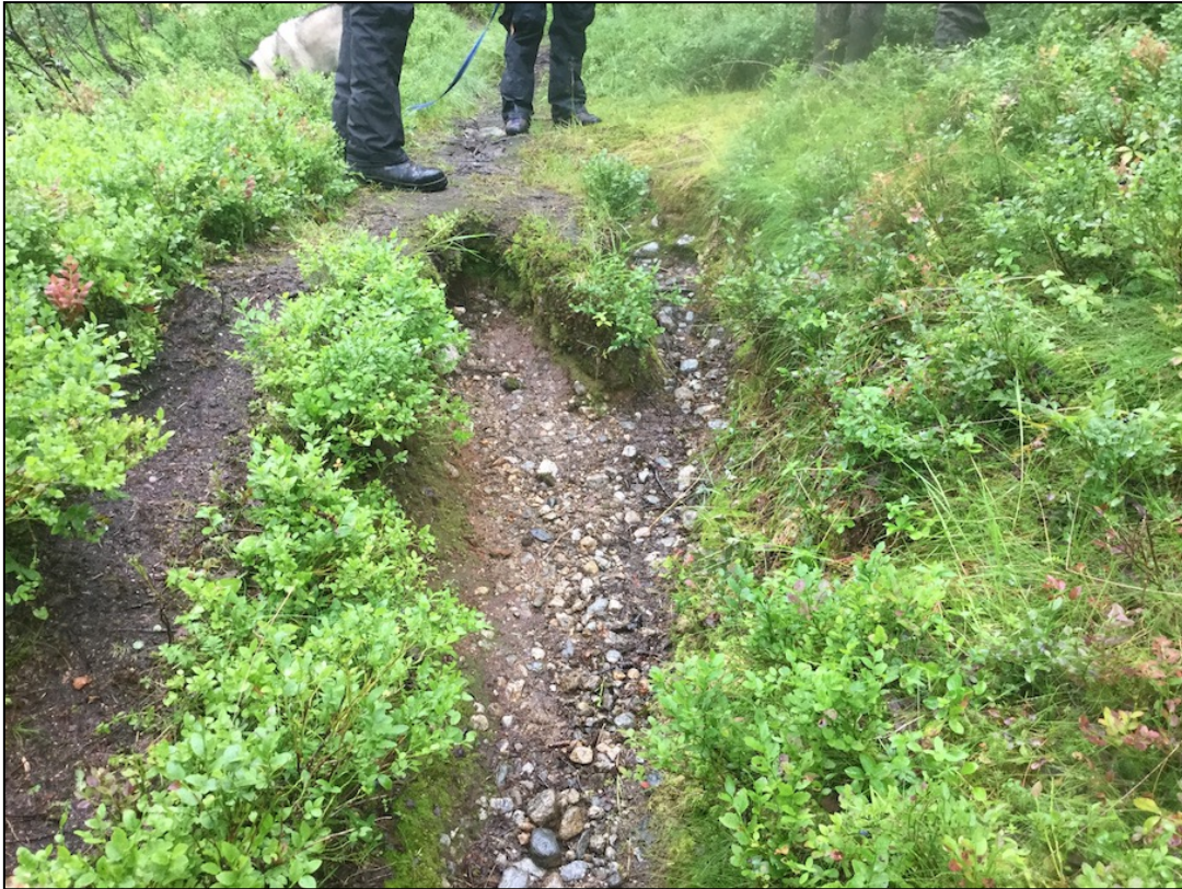
Figur 6 Parti av stien inn til Muldal- og Tafjordsætra der vatnet har fått tak og grove seg ned i lausmassane. Ikkje minst kan det vere trong for å leie vatnet vekk frå stien slik at det ikkje grev enno meir. Truleg er det vanskeleg å gjere noko meir med den delen som alt har vorte skada, utan å frakte hit massar og fylle att. Foto: Geir Gaarder
