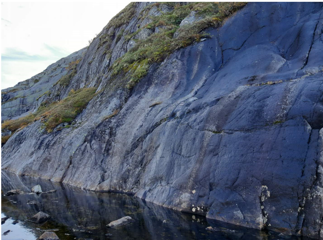
Foto av strekninga det skal murast opp ein gangsti under fjellveggen. Fotoretning mot sør.
