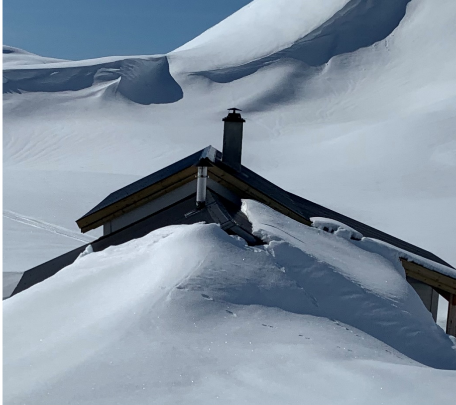
Figur 3 Bildet viser dagens situasjon med ulik høyde og vinkel på taket på dei to bygga som er bygd saman. Foto Sjur Vikøren
