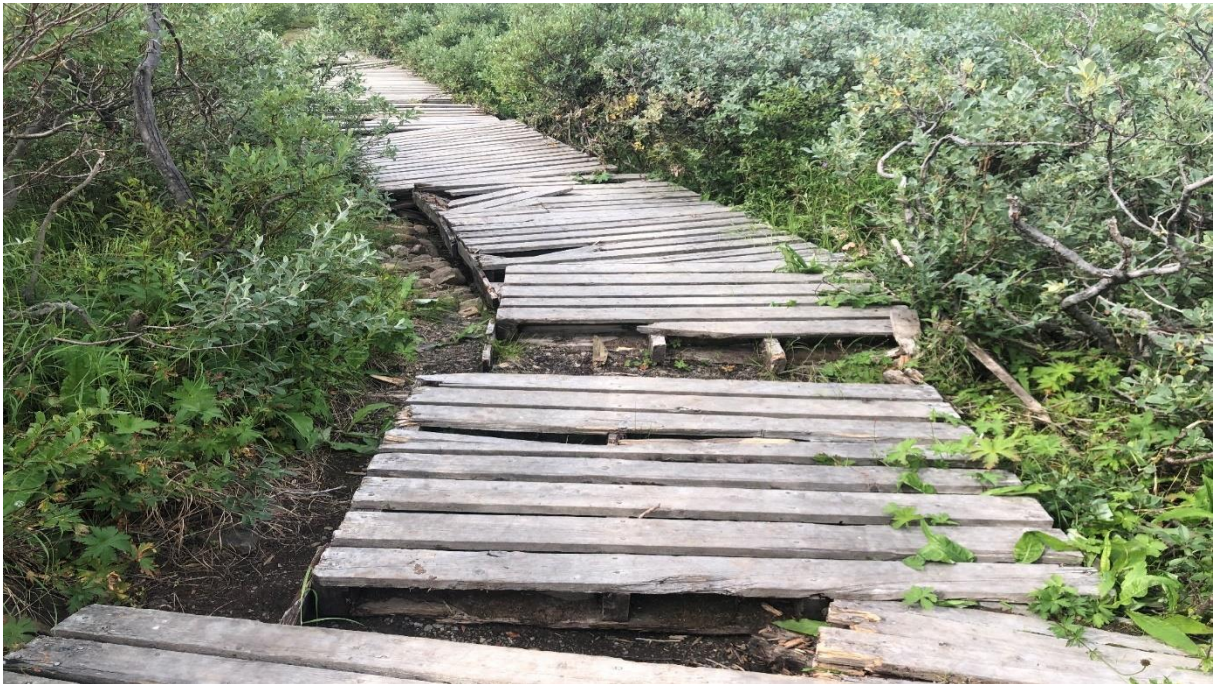
Klopp ved brua over Storelva som man må krysse på vei opp til Nattfjelldalen – skiftes ut. Materialer innkjøpt i 2023, arbeidet med utfrakt og montering gjenstår.
